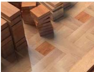
Acopio ordenado de piezas de madera durante el montaje de pavimentos ligeros
