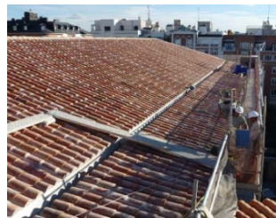
Pasarelas de acceso/paso en cubiertas
