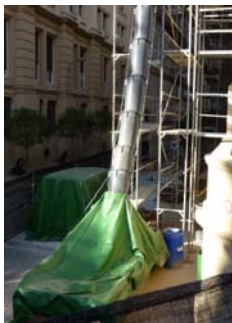
Base de la tolva
