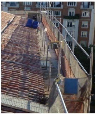
Plataforma de trabajo del andamio de anchura suficiente
